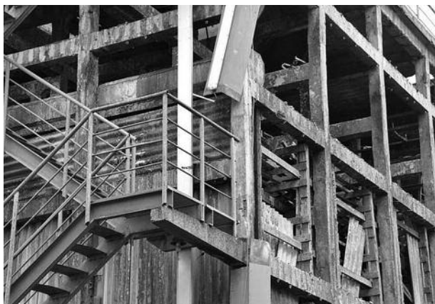
Ryc. 4. Przykład ułożenia płyt azbestowych (falistych) w remontowanym zraszalniku chłodni wentylatorowej (fot. Uniserw, za zgodą autora)
